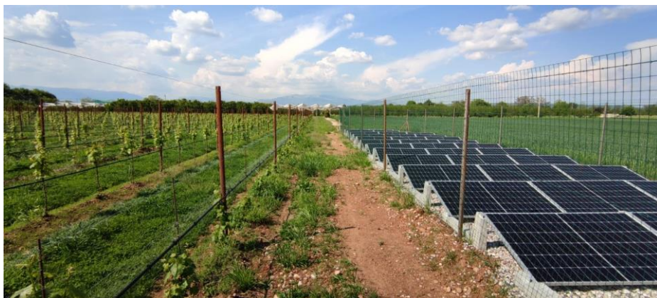
Fotovoltaico per alimentare pompe di irrigazione vigna
