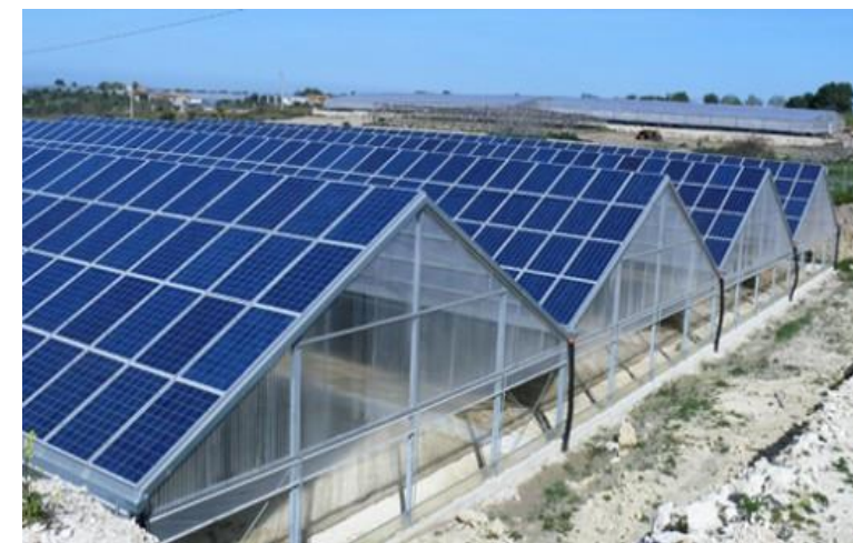
Tetto fotovoltaico su falda di serra
